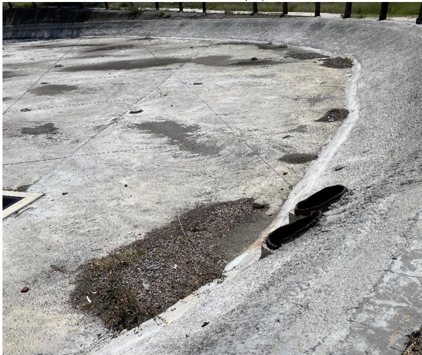
Fotografía 7. Situación actual lago desecado Parque Acoatl. Fuente: Elaboración propia.
